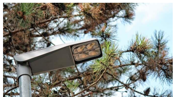
Figure 2: Lampadaire LED à Kehl.
