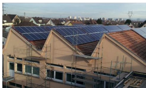
Figure 2: Les installations photovoltaïques sur les toits de bâtiments industriels de Colmar.
